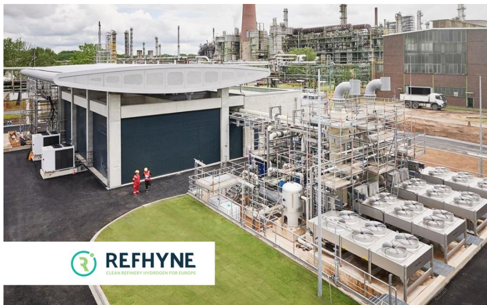
L'elettrolizzatore REFHYNE produce attualmente idrogeno rinnovabile presso la raffineria Shell in Renania
